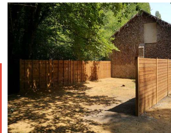
Création d'un pas de tir à l'arc sur la base kayak de Pont-Saint-Pierre
